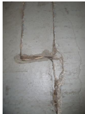
De vloer is op enkele plekken erg beschadigd
