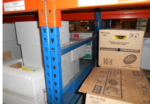
Hier ontbreekt de diagonaalschoor, deze horizontale schoring hoort hier niet
